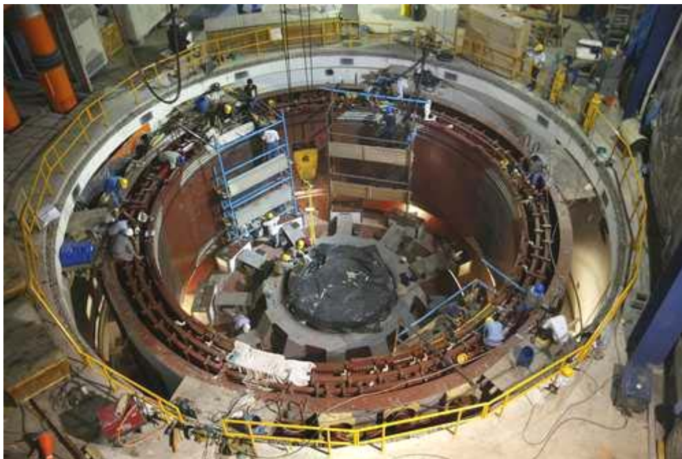
Extractor en el cuarto de máquinas, Central Hidroeléctrica El Cajón FOTO: J. C. González
