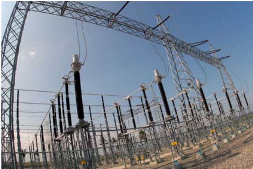
Subestación eléctrica Tuxpan
