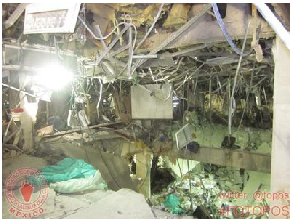
Interior de la zona siniestrada FOTO: Topos
