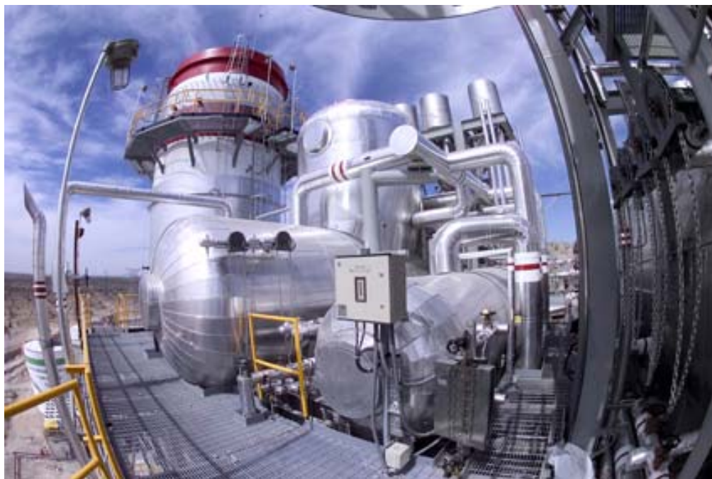
Central eléctrica de ciclo combinado "Hermosillo"
