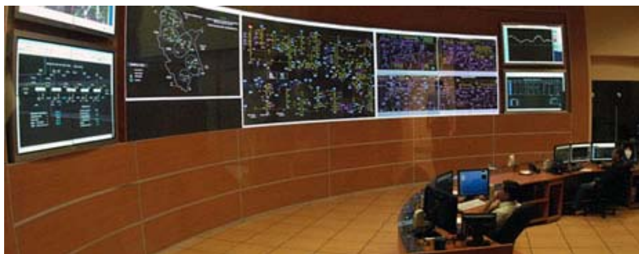
Centro Nacional de Control de Energía
