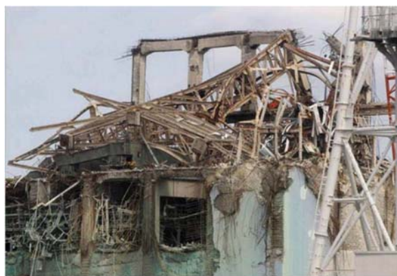
Nivel de destrucción del reactor 3 en Fukushima.
