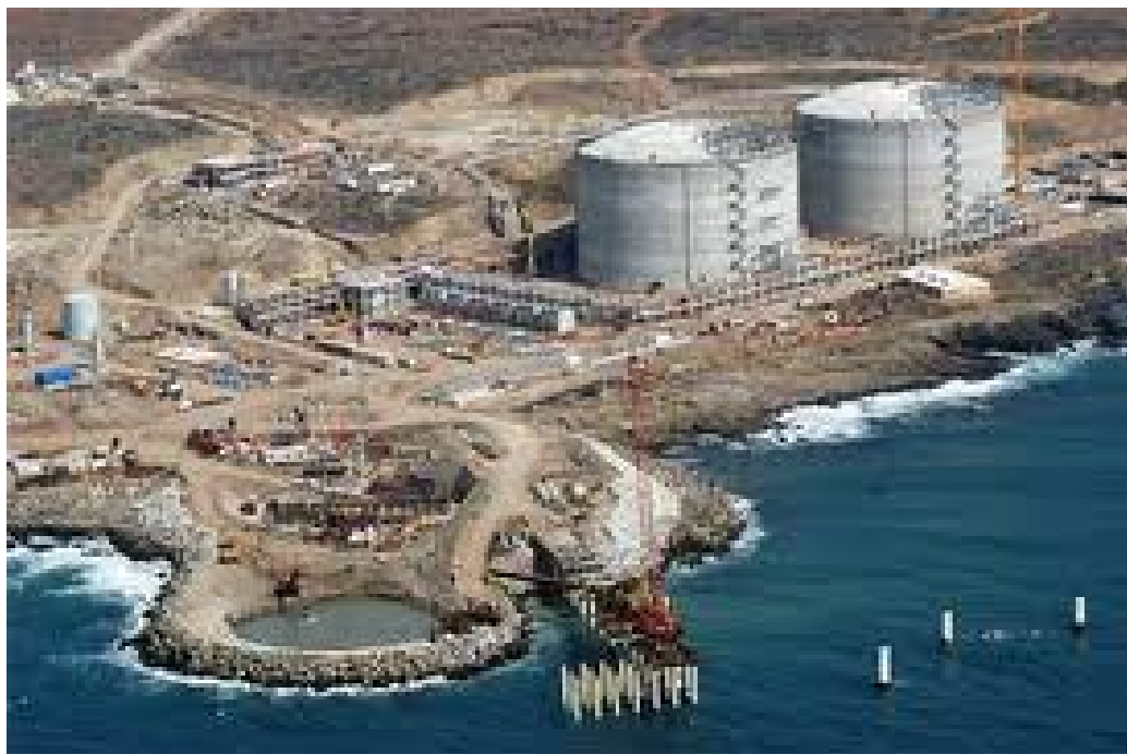
Regasificadora en Manzanillo, construida por la CFE y entregada a Repsol
