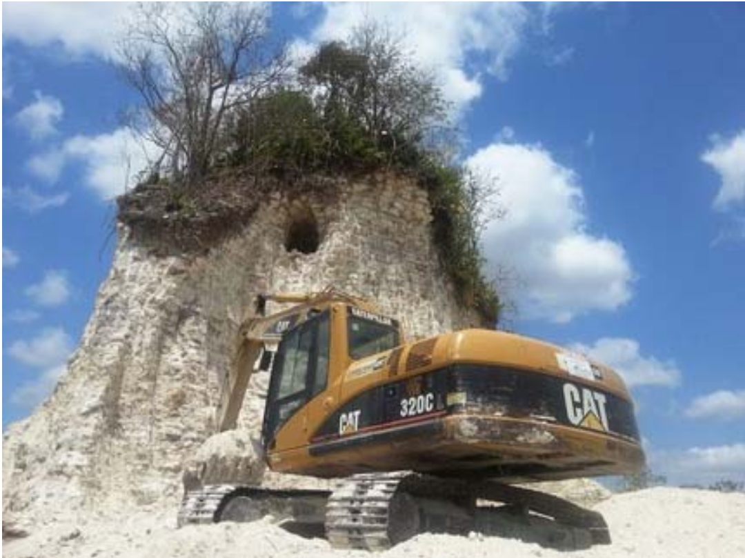
Pirámide Nohmul destruida para reparar carreteras
